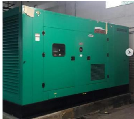
Imagen N°3. Generador de emergencia con capacidad de 500 KVA
