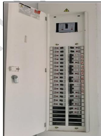
Imagen N°1. Aspecto del tablero de distribución de la zona de verde
