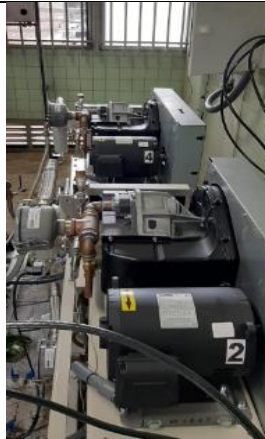
Imagen N°5. Compresores de aire etapa de captación de aire.
