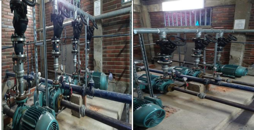
Imagen N°4. Arranque controlado bombas centrifugas por sistema variador de velocidad
