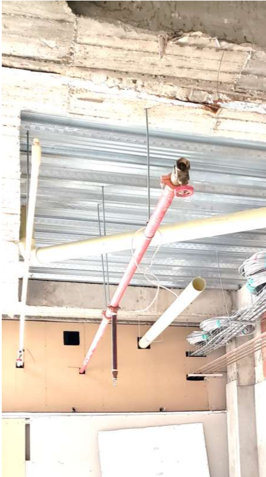
Redes hidráulicas, sanitarias y red contra incendios
